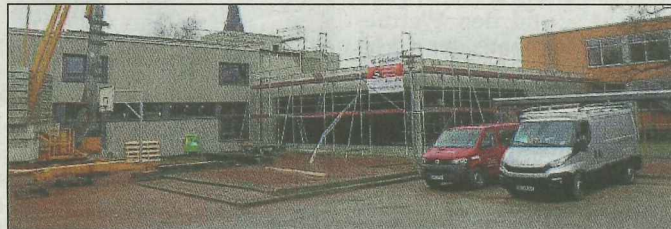
Der neue Bauteil Mensa/Foyer des neuen Standorts der Ludgerus-Grundschule ist im Bau schon weit fortgeschritten.
